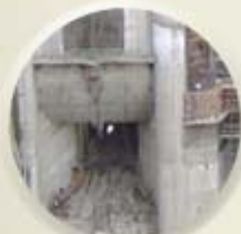
Tomada de Água
